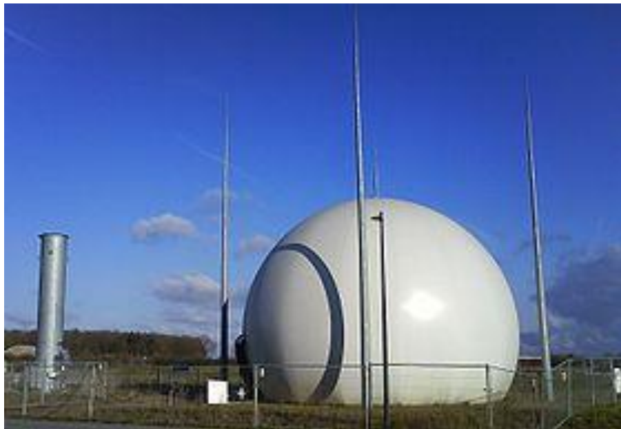
Εγκαταστάσεις αναερόβιας πέψης
